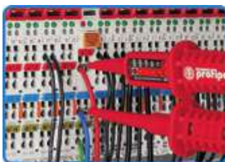
Проверка наличия напряжения в системе WAGO-I/O-SYSTEM 750
