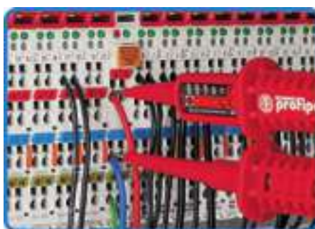
Проверка наличия напряжения в системе WAGO-I/O-SYSTEM 750
