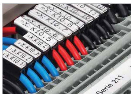
Маркировка проводников с помощью маркировочных манжет.
