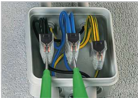
Измерение напряжения через отдельные тестовые гнезда.
