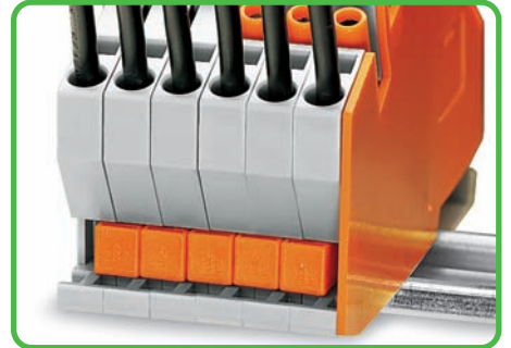
Подготовленная для исполнительных схем трансформаторов тока клеммная колодка со вставленными закорачивающими перемычками.
